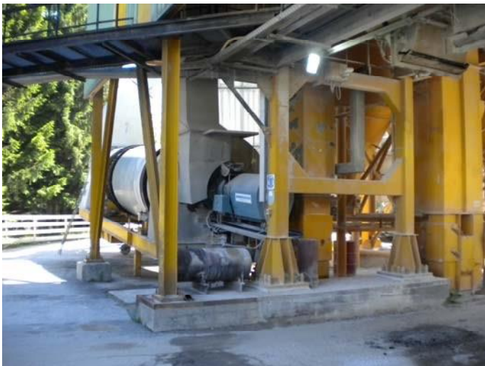
Asphaltmischanlage: Asphalt Allemagne Type: WIBAU WKM 130/160-5 Kom Nr: 117188 BJ 1982
